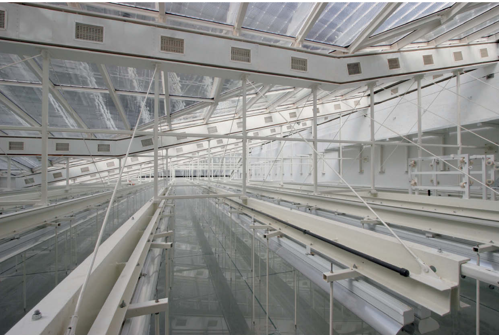
Im Deckenhohlraum der Lichtdecke. Die Glasdecke ist begehbar. Für Revisionsarbeiten ist eine Befahranlage eingebaut
