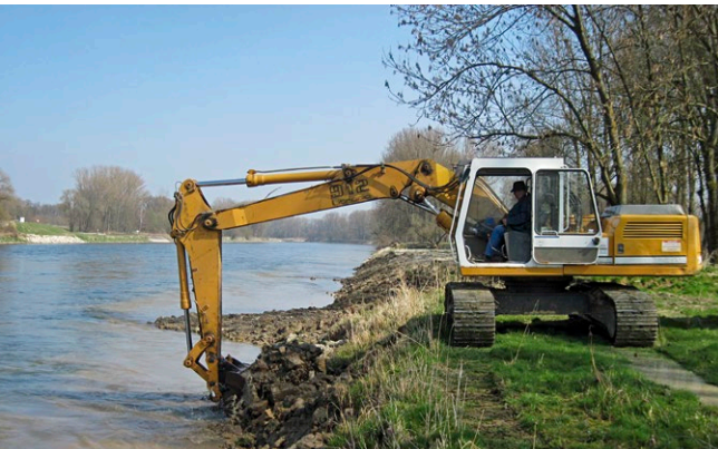
Entfernung der Uferversteinung lässt Seitenerosion zu (Donau zwischen Vohburg und Neustadt)
