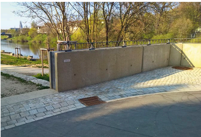
HWS-Wand mit Dammbalkenverschluss
